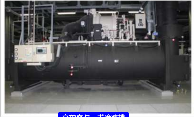
高効率ターボ冷凍機
